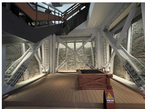
写真6 クロスダンパー（小天守地下1階）
